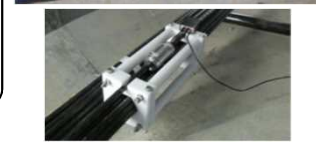
センサーによる橋梁ケーブル張力のモニタリング
