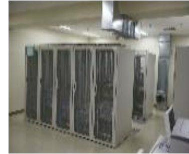
変電所・事務所
