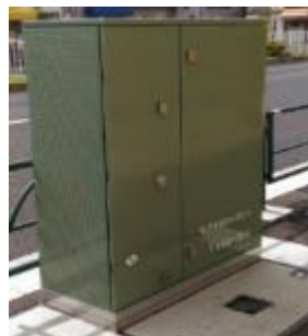
配電地上機器
