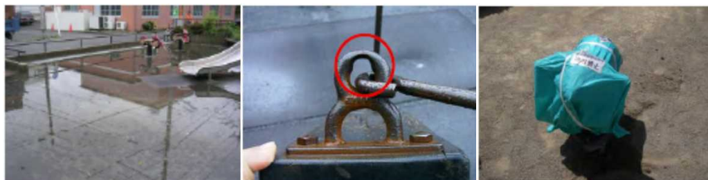
▲ 広場 排水不良
