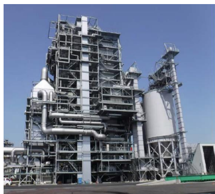
実証実験中： 株式会社シグマパワー有明 三川発電所（福岡県大牟田市）
