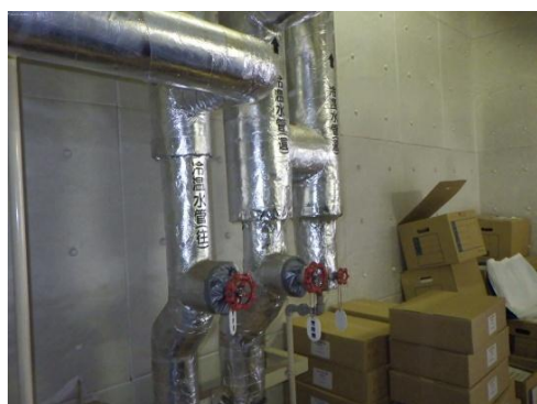
屋内設置(1. 市民センター)
