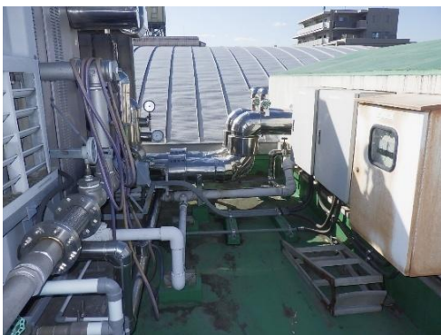
屋外設置(1. 市民センター)
