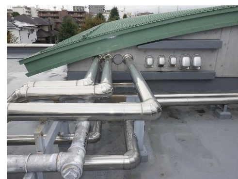
屋外設置(3. 体育館)
