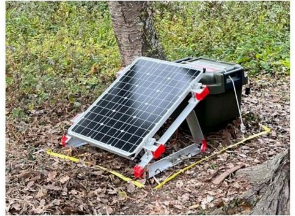
画像データ送受信機器・電源（親機）の設置例
