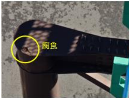
A1 部 12 番梁の腐食 (自動検査)
