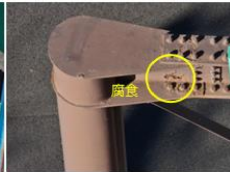
A1 部 13 番梁の腐食 (自動検査)
