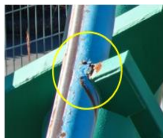
A2 部スパイラル導入部 手動検査時には発見できなかった 軌条・枕木接合部の腐食
