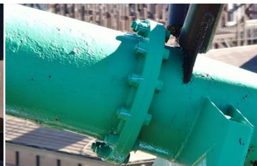
A2 部スパイラル上部桁取付け部分（自動検査） ボルトと合いマーク
