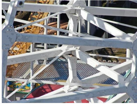
図 51 接合部における錆などの発生状況（観覧車）
