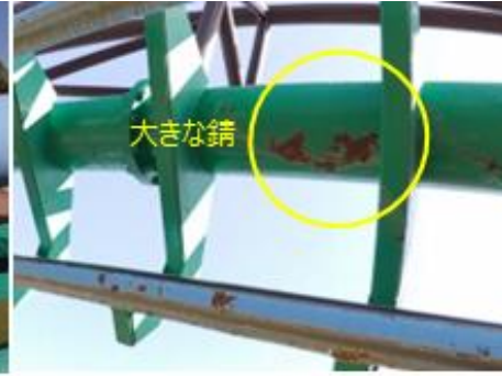
A2 部スパイラル上部の錆 (手動検査)
