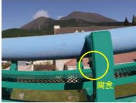
A1 部枕木の腐食 (手動検査)
