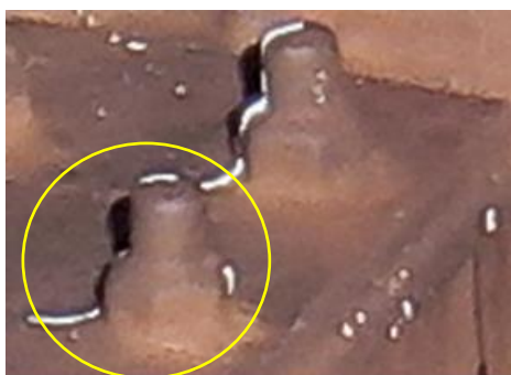
A1部 15番梁（自動検査） 白いラインの一部がボルトの背後に 隠れてしまっている
