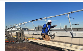
「ラインドローンシステム」のドローン機体の浮上頂点箇所における地上部への停止合図模様
