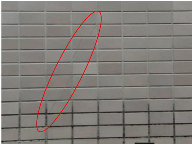
図 59 遠隔点検（ドローン）で発見された2階中央付近のひび割れ （モニター映像のスクリーンショット）
