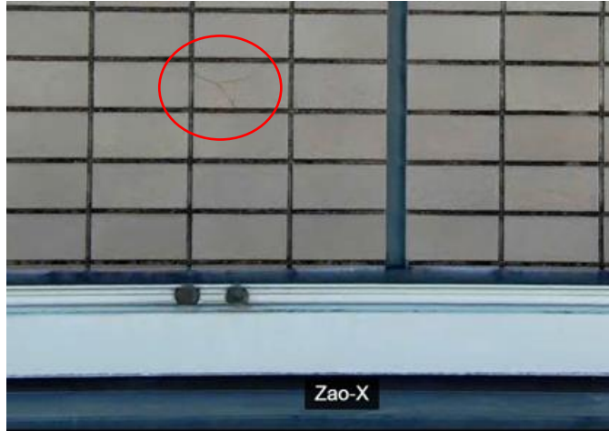
図 56 遠隔点検（ドローン）で発見された 6 階北側のひび割れ （モニター映像のスクリーンショット）
