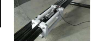
センサーによる橋梁ケーブル張力のモニタリング
