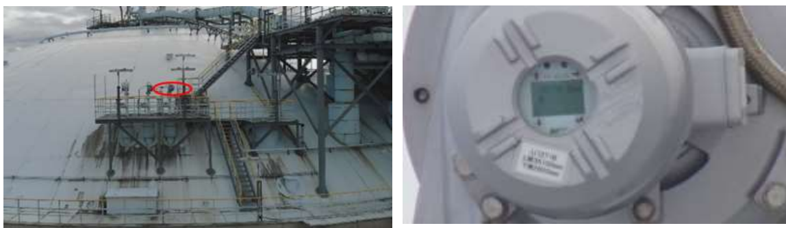
図 92 LNG 貯槽上部に設置されているデジタルメーターの撮影結果 (左側:全景、右側:左の赤丸箇所の拡大図)
