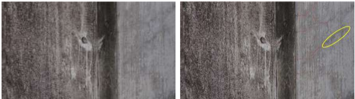
図 116 LPG 貯槽の基礎のひびの AI 解析結果 1 (赤線 : 検知されたひび)
