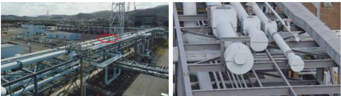
図 82 配管ラックと配管の錆の撮影結果 2(左側:全景、右側:左の赤丸箇所の拡大図)
