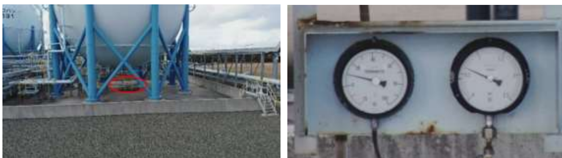
図 93 LPG 貯槽の下部に設置されているメーターの撮影結果 (左側:全景、右側:左の赤丸箇所の拡大図)
