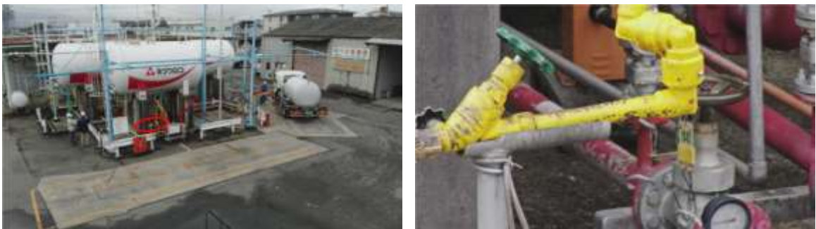
図 62 ローディングアームにおける錆の撮影結果(左側:全景、右側:左の赤丸箇所の拡大図)
