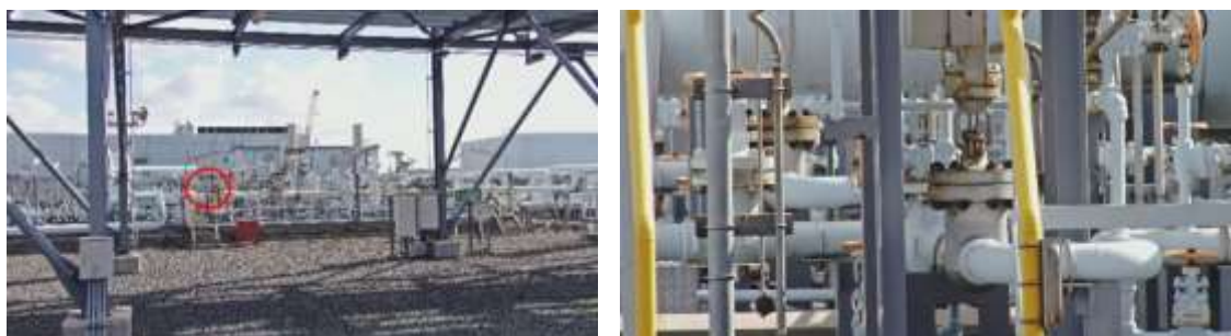
図 79 LPG 増熱器の手前側の錆の撮影結果(左側:全景、右側:左の赤丸箇所の拡大図)
