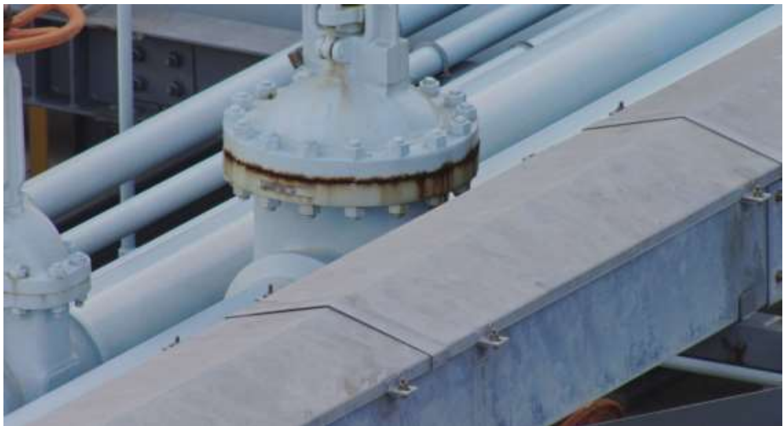
図 25 LPG 貯槽に付近の配管フランジの錆を撮影している様子
