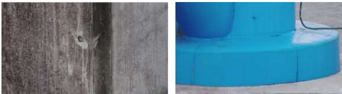
図 164 LPG 貯槽の基礎のひびの撮影結果
