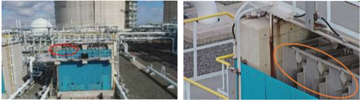
図 75 LNG 気化器の正面の錆の撮影結果 (左側:全景、右側:左の赤丸箇所の拡大図、橙色丸箇所は流水部分)
