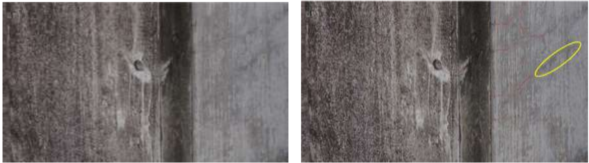
図 171 LPG 貯槽の基礎のひびの AI 解析結果 凡例 : 検知されたひび : 未検知 : 誤検知
