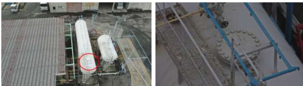
図 104 LPG 貯槽の上部の錆の撮影結果(左側:全景、右側:左の赤丸箇所の拡大図)
