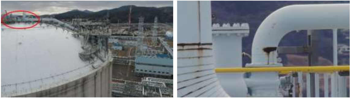
図 67 LNG 貯槽の上部の錆の撮影結果(左側:全景、右側:左の赤丸箇所の拡大図)
