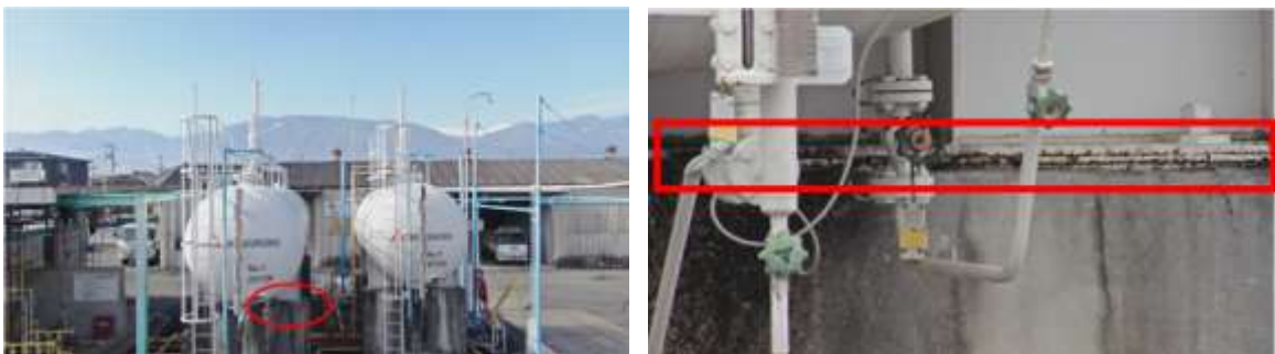
図 51 LPG 貯槽の基礎部分の錆の撮影結果(左側:全景、右側:左の赤丸箇所の拡大図)
