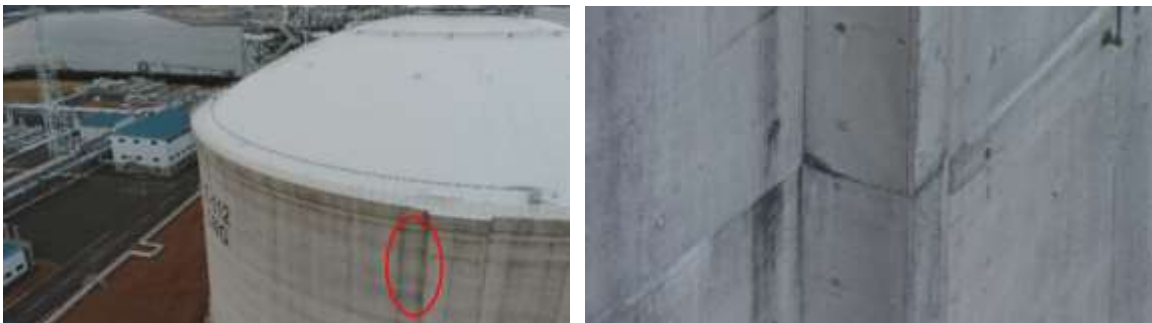
図 69 LNG 貯槽の側面のひびの撮影結果(左側:全景、右側:左の赤丸箇所の拡大図)
