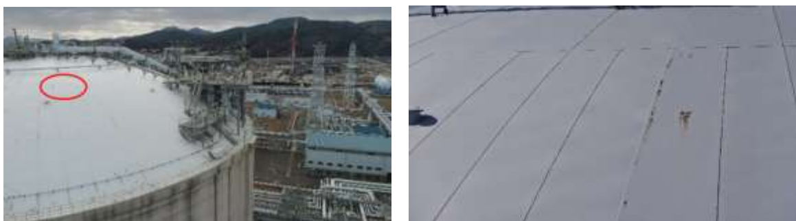
図 109 LNG 貯槽の弧の箇所の錆の撮影結果(左側:全景、右側:左の赤丸箇所の拡大図)
