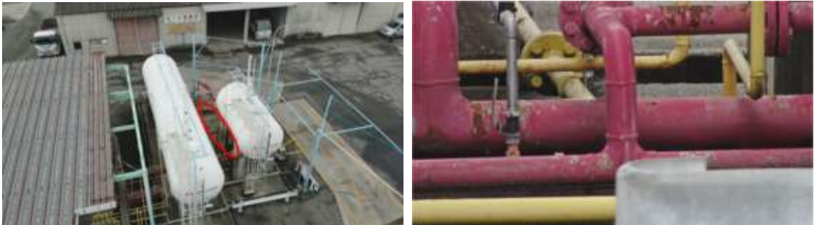
図 55 配管の錆の撮影結果(田富事業所 左側:全景、右側:左の赤丸箇所の拡大図)
