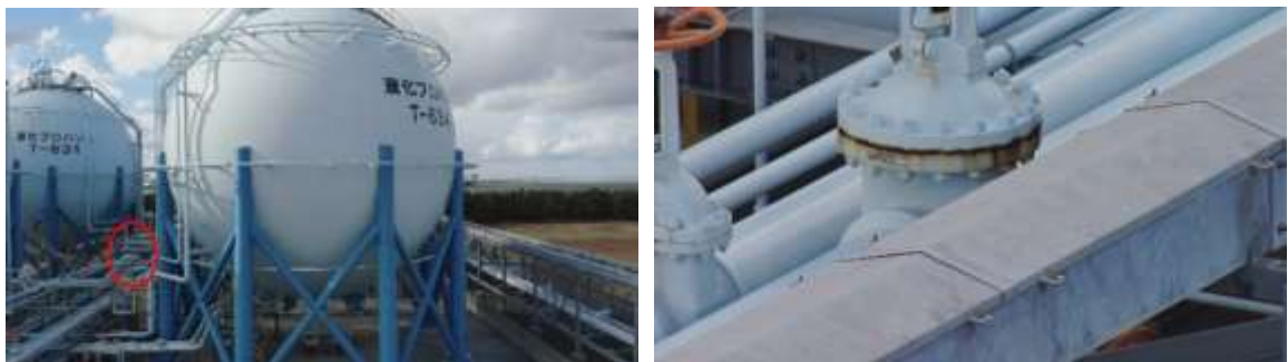
図 71 LPG 貯槽の配管部分の錆の撮影結果(左側:全景、右側:左の赤丸箇所の拡大図)
