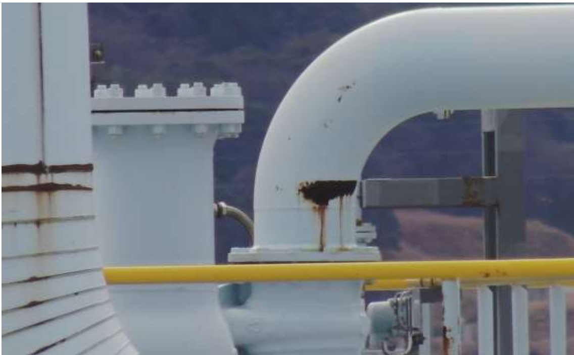
図 21 貯槽上部の配管錆をズームカメラで撮影した様子
