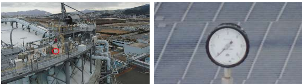
図 91 LNG 貯槽上部に設置されているメーターの撮影結果 (左側:全景、右側:左の赤丸箇所の拡大図)
