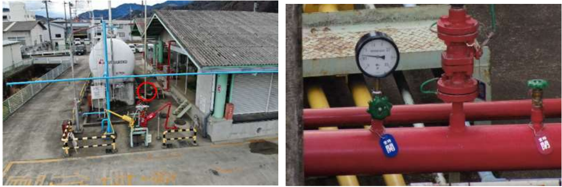
図 86 配管に設置されているメーターの撮影結果(左側:全景、右側:左の赤丸箇所の拡大図)
