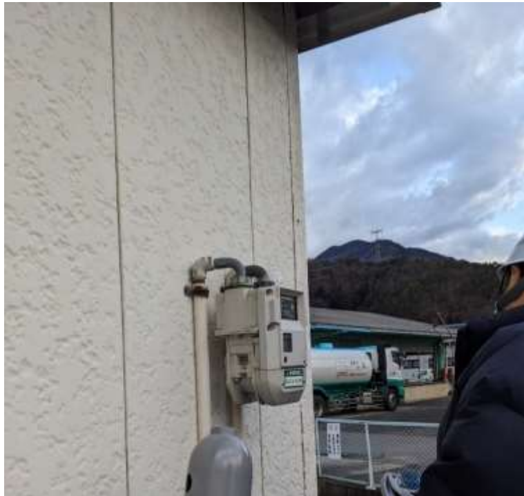
図 38 試験用設備でガス漏れを起こす様子
