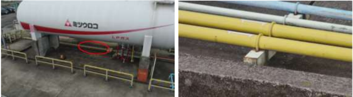
図 54 配管の錆の撮影結果(左側:全景、右側:左の赤丸箇所の拡大図)
