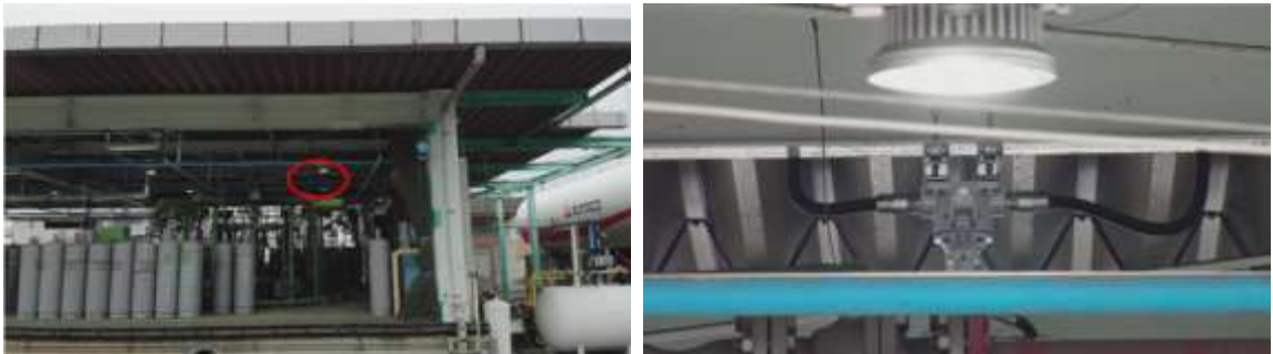
図 108 充てん機の上部の撮影結果 (左側:全景、右側:左の赤丸箇所の拡大図)
