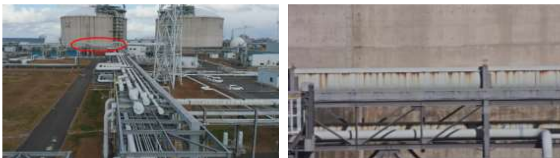
図 114 配管ラックと配管の錆の撮影結果(左側:全景、右側:左の赤丸箇所の拡大図)
