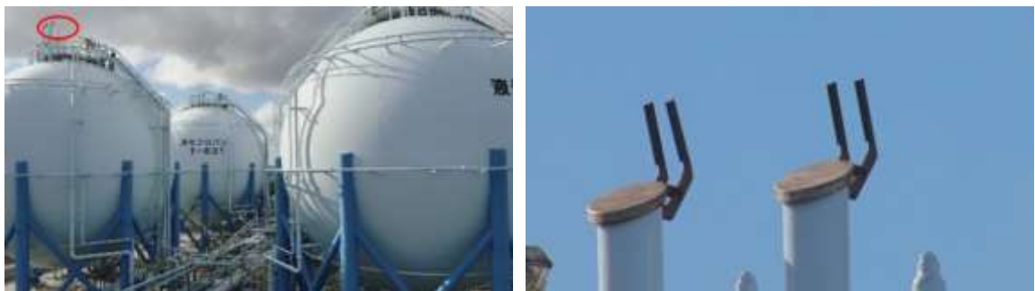
図 72 LPG 貯槽の上部の撮影結果(左側:全景、右側:左の赤丸箇所の拡大図)
