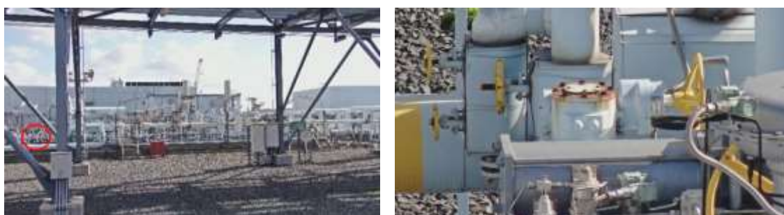
図 78 LPG 増熱器の錆の撮影結果(左側:全景、右側:左の赤丸箇所の拡大図)
