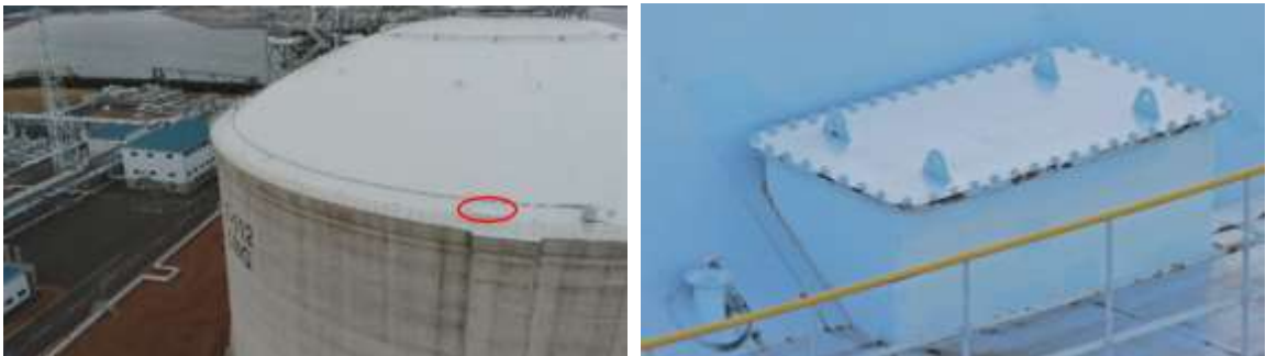
図 68 LNG 貯槽の足場付近の錆の撮影結果(左側:全景、右側:左の赤丸箇所の拡大図)
