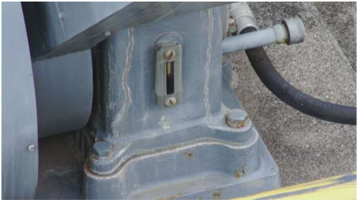
図 33 圧縮機の点検
