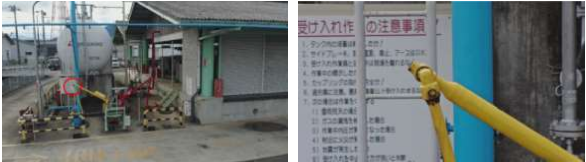
図 61 ローディングアームの接合部分の錆の撮影結果 (左側:全景、右側:左の赤丸箇所の拡大図)
