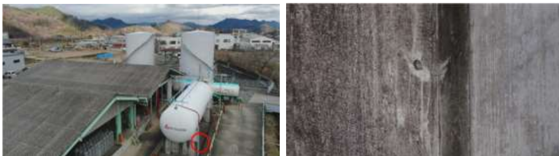
図 52 LPG 貯槽の基礎部分のひびの撮影結果(左側:全景、右側:左の赤丸箇所の拡大図)
