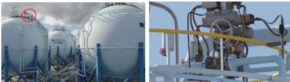
図 111 LPG 貯槽の上部の錆の撮影結果(左側:全景、右側:左の赤丸箇所の拡大図)
