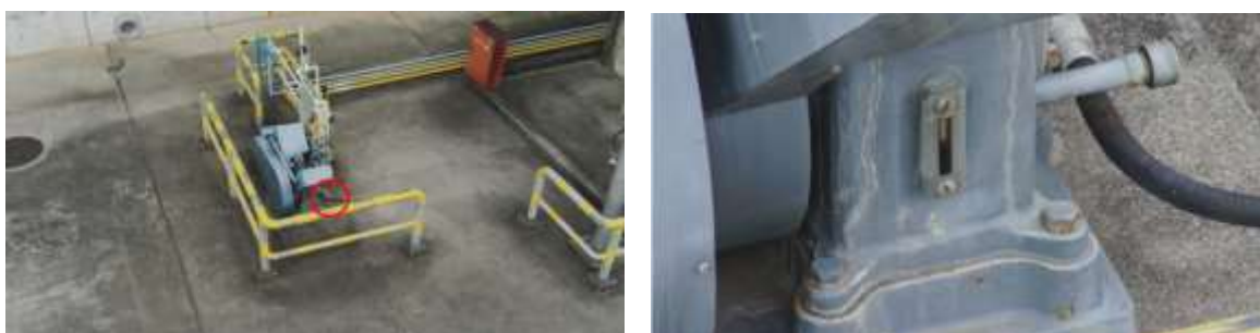
図 64 圧縮機の錆の撮影結果(左側:全景、右側:左の赤丸箇所の拡大図)
