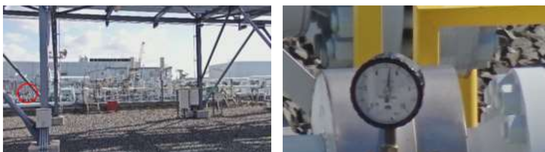
図 96 LPG 増熱器に設置されているメーターの撮影結果 2 (左側:全景、右側:左の赤丸箇所の拡大図)
