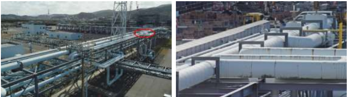
図 81 配管ラックと配管の錆の撮影結果 1(左側:全景、右側:左の赤丸箇所の拡大図)
