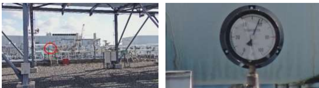
図 95 LPG 増熱器に設置されているメーターの撮影結果 1 (左側:全景、右側:左の赤丸箇所の拡大図)
