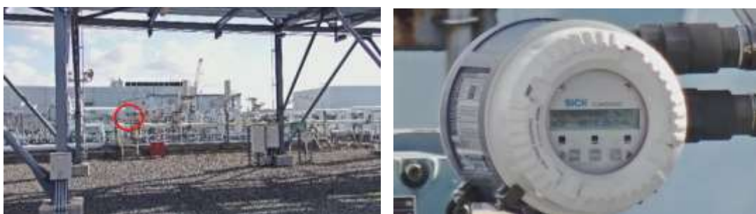
図 98 LPG 増熱器に設置されているデジタルメーターの撮影結果 (左側:全景、右側:左の赤丸箇所の拡大図)
