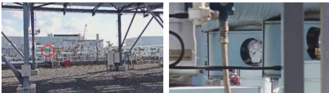
図 97 LPG 増熱器に設置されているメーターの撮影結果 3 (左側:全景、右側:左の赤丸箇所の拡大図)
