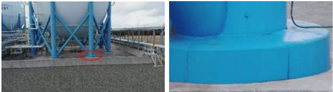
図 73 LPG 貯槽の基礎部分のひびの撮影結果(左側:全景、右側:左の赤丸箇所の拡大図)
