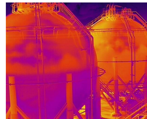
LPG貯槽をサーマルカメラで確認した様子
