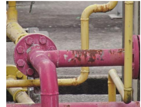
配管錆を撮影した様子
