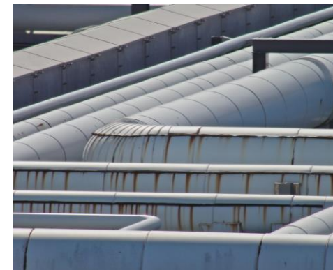
配管ラックの錆を撮影した様子
