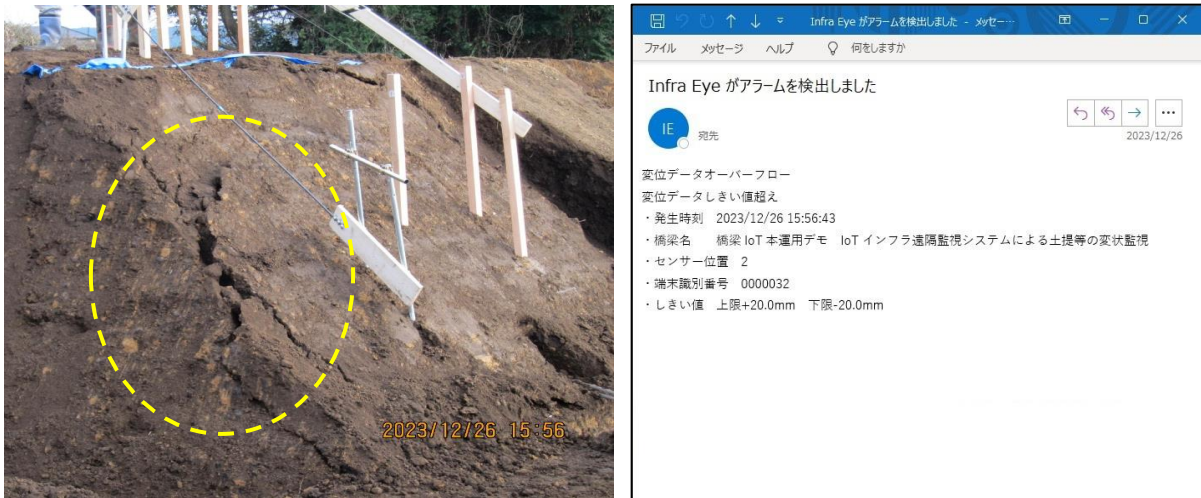
図 46 盛土構造物の崩壊（地割れ）の状況と受信アラームメール
