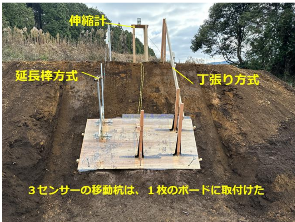
図 12 盛土構造物における機器設置状況
