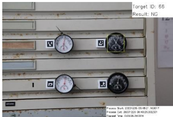
図 83 温度計の外観の劣化あり※
