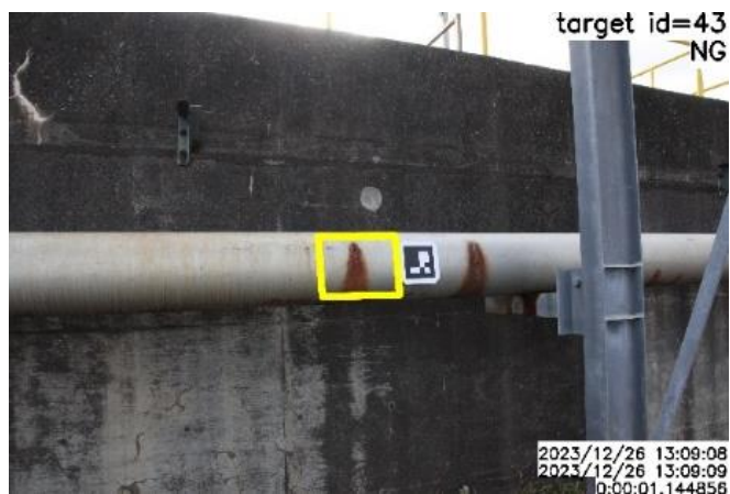
図 80 配管の劣化あり※
