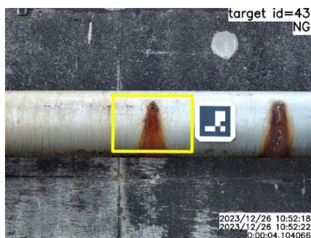
図 41 配管の劣化ありの画像※
