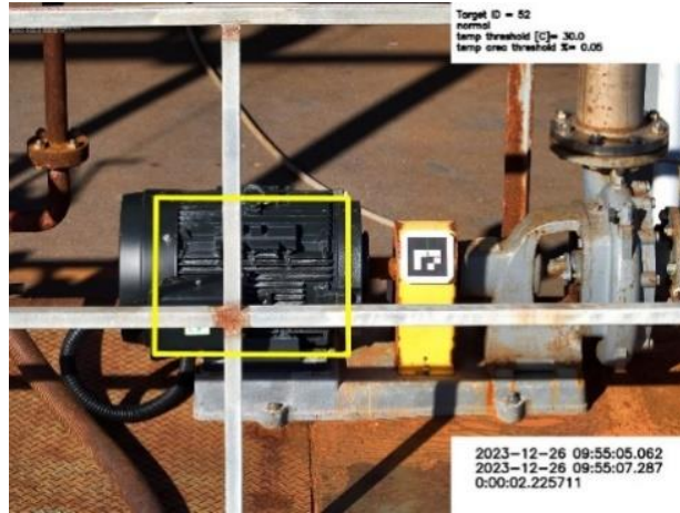
図 42 設備の温度が正常の画像
