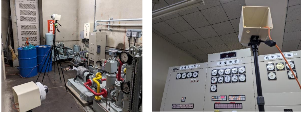
図 19 下赤発電所での検証の様子
