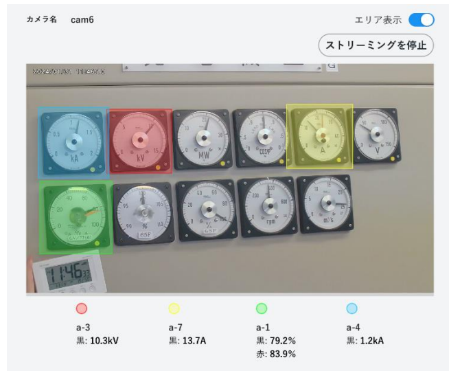
図 30 ライブ映像確認画面（時計を映して遅延を計測した様子）
