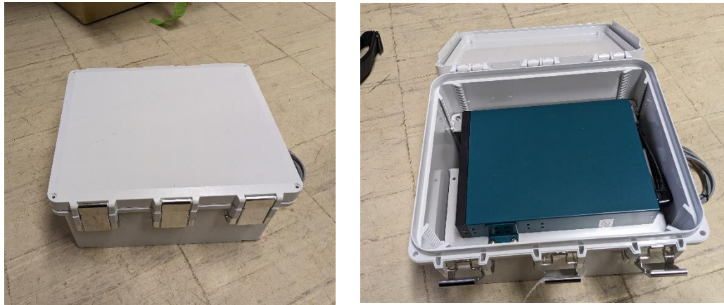
図 21 IP66 対応ボックス（右は PoE ハブを設置した状態）
