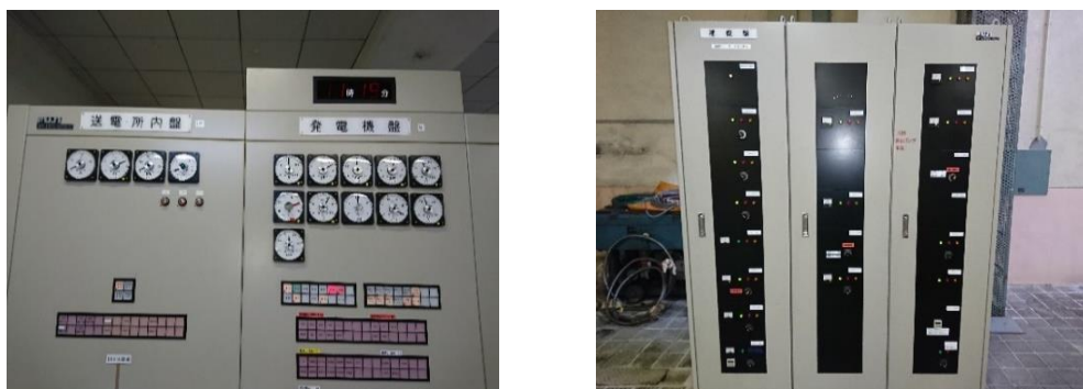
図 9 実証対象のアナログ計器 (左：下赤発電所の丸型計器、右：北川発電所の角型計器)
