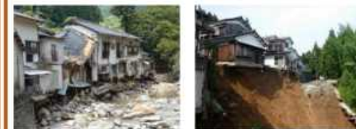
<平成29年台風18号等での基礎・地盤被害による住家被害の例>
