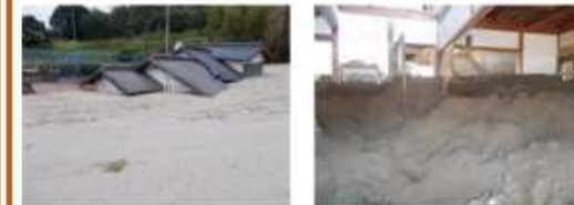
<平成28年九州北部豪雨での土砂堆積等による住家被害の例>
