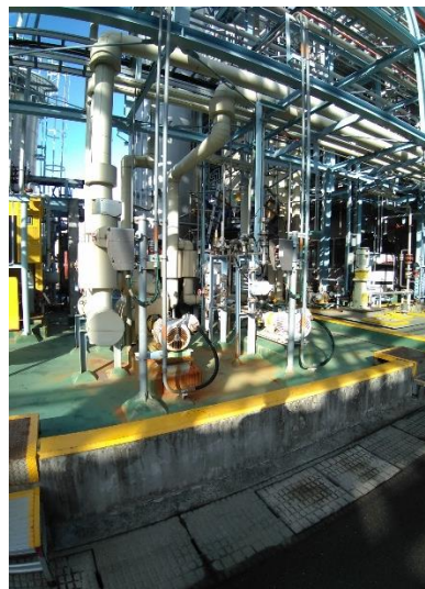
第二地点：高圧ガス製造事業所 プラントβ地上部
